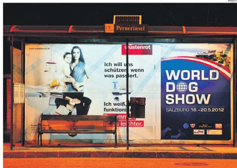
Im Tennengau werden 123 Bushaltestellen mit Solarpaneelen ausgestattet. Stromleitungen zu legen, wäre zu teuer und aufwendig gewesen
